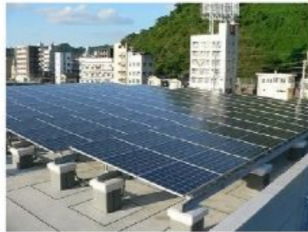
太陽光発電設備（環境未来館屋上）
